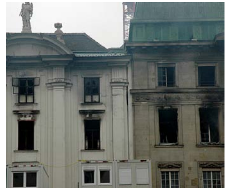
Auch ein Teil des Kirchenkomplexes, der zur ehemaligen Bank gehörte, sowie das dahinterliegende Konventsgebäude wurden vom Brand beschädigt.
